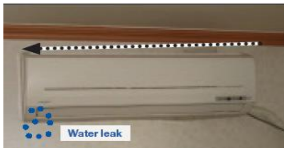
Блок установлен не по уровню
