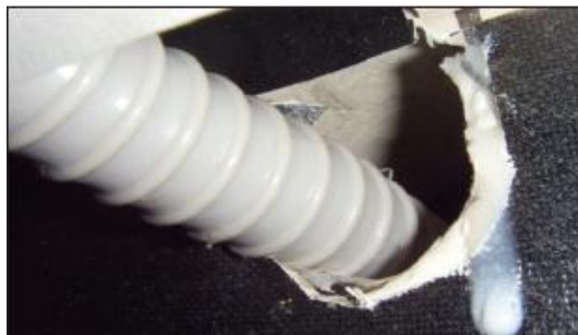
Дефект при установке дренажного шланга
